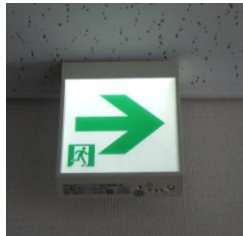
通路誘導灯（避難方向がわかる）
